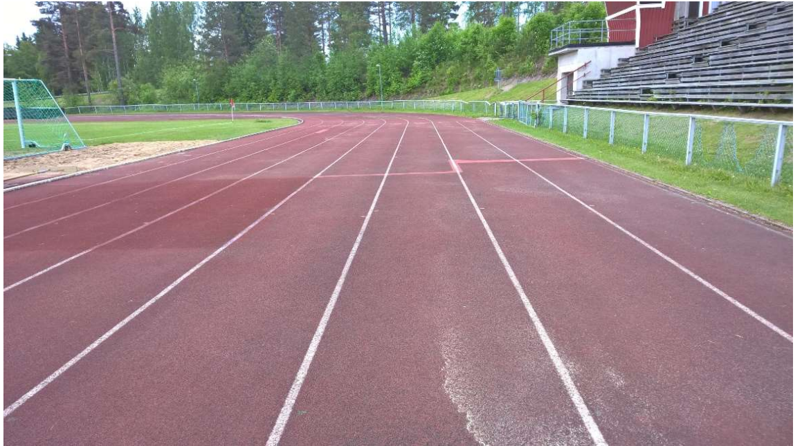
Kuva 7b. Juoksuradan painumia ja korjauksia.
